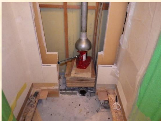
【既存排水特殊継手の上にベニヤ板を敷き油圧ジャッキを設置】
