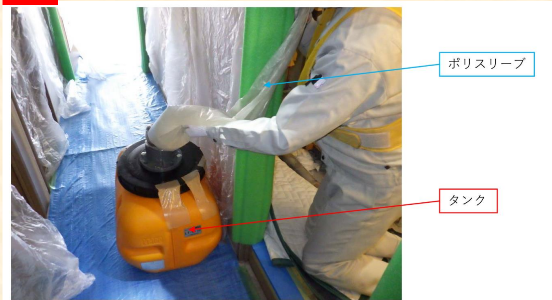
【立管バルブ以降にポリチューブを接続し密閉タンクへ排水が流れている状況】
